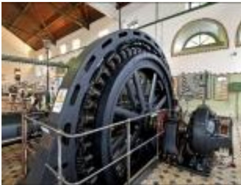
Bild: Betrieb Generator und Erreger
