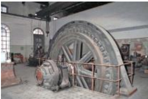
Bild: Erster Augenschein Generator
